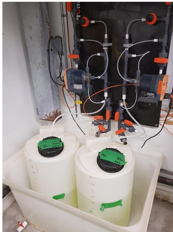
Photo 26 – Vue des réservoirs (100 L) d'hypochlorite de sodium.
