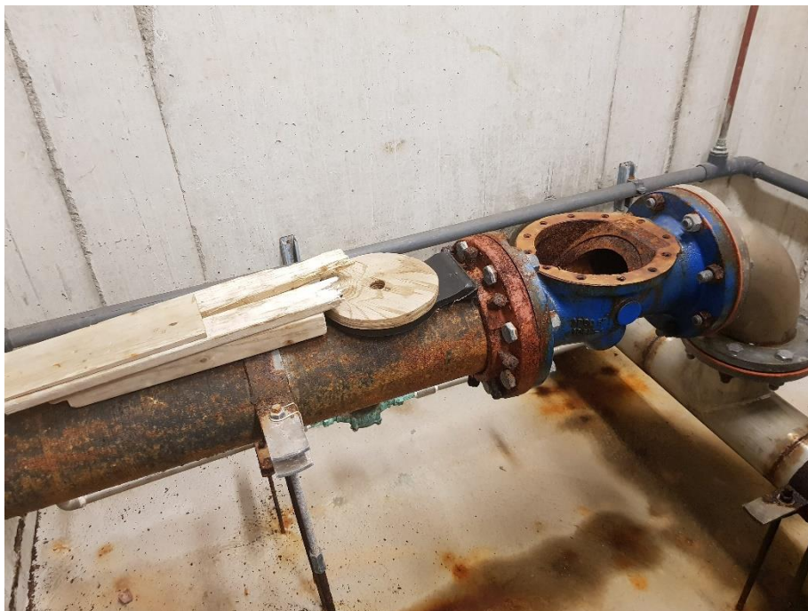
Photo 30 – Vue du système de trop-plein du système de distribution en eau de la Municipalité de Saint-Ferdinand
