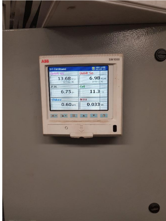
Photo 29 – Vue du panneau de contrôle Schneider, à l'intérieur du poste de pompage et de traitement.
