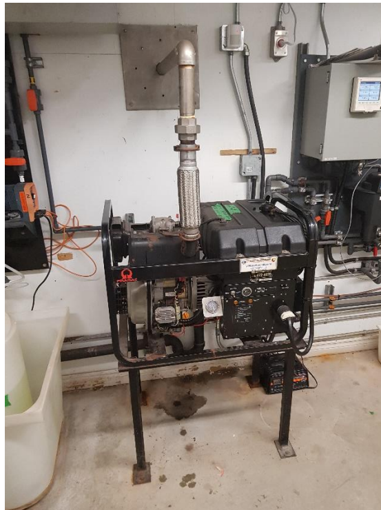
Photo 24 – Vue de la génératrice à l'intérieur de l'installation de pompage et de traitement.
