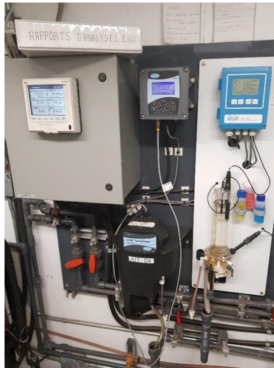
Photo 25 – Vue du doseur d'hypochlorite en solution à l'intérieur de l'installation de traitement.
